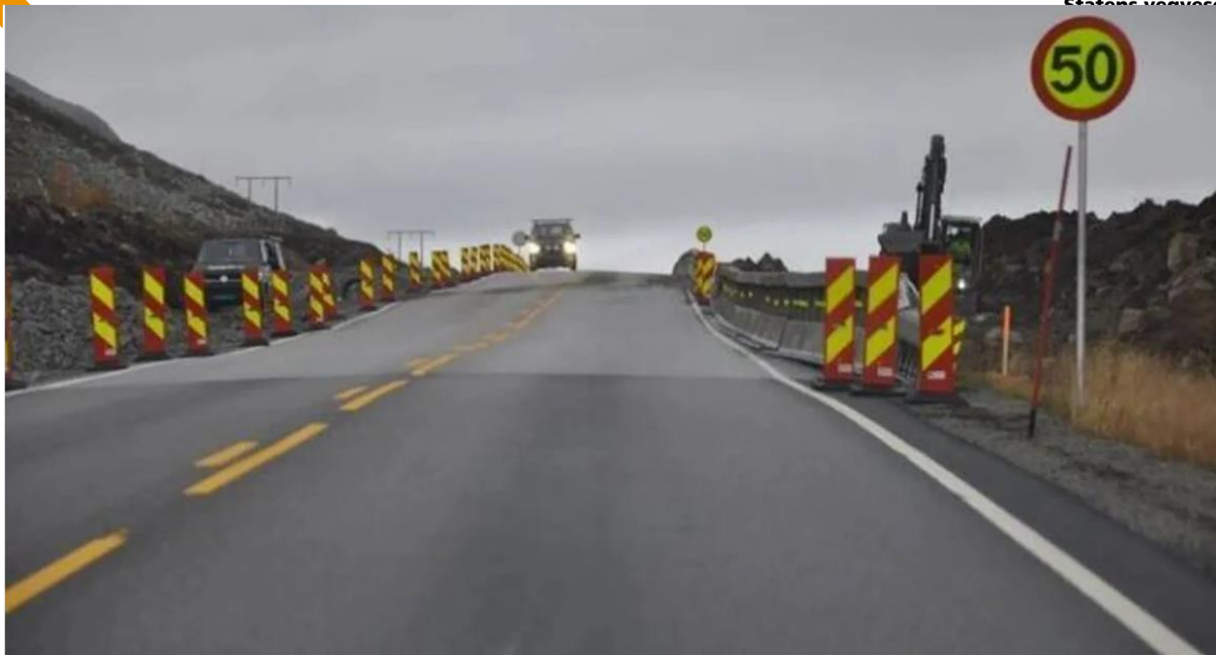
Det pågår arbeid tett på fire kilometer av riksvei 52 på Hemsedalsfjellet. (Foto: Kjell Wold)
